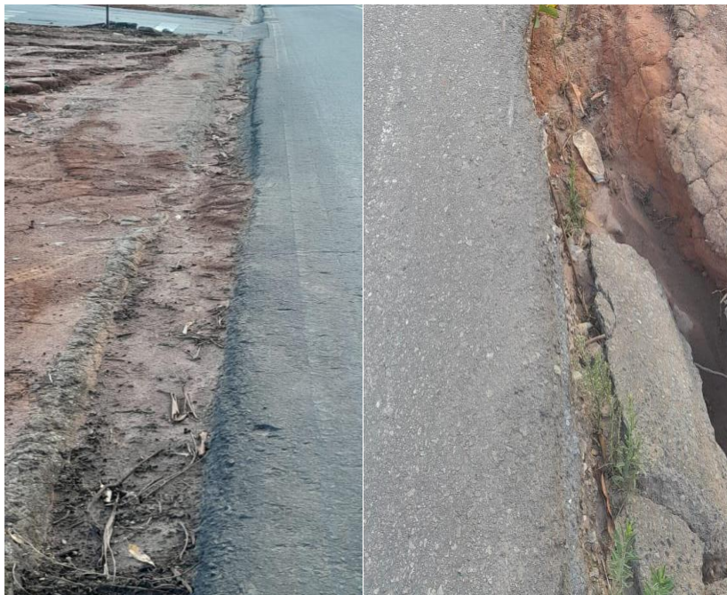
Figura 2: Sarjetas inadequadas e sem manutenção Fonte: Autores (2023)
